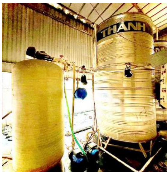
Hình 3.16 Hệ thống xử lý nước cứng
