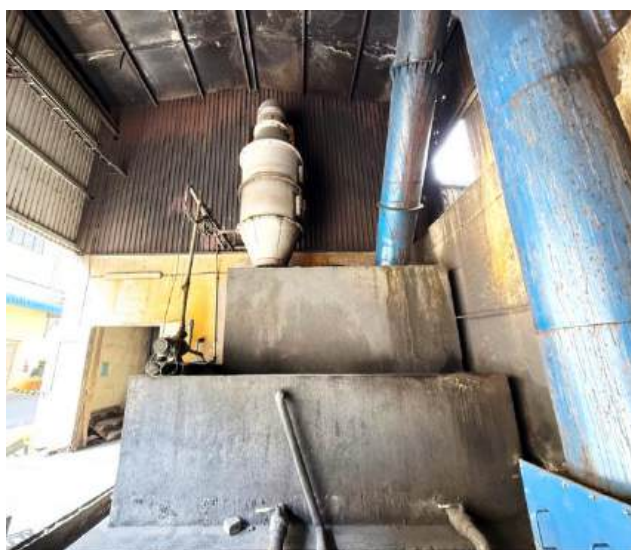
Hình 3.14 Hệ thống xử lý khí thải lò hơi, công suất 6 tấn/h
