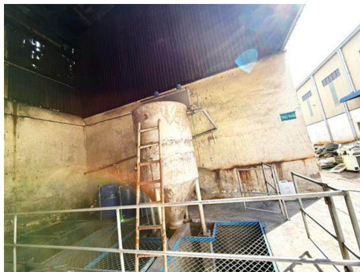
Hình 3.17 Hệ thống xử lý nước cấp đầu vào của lò hơi
