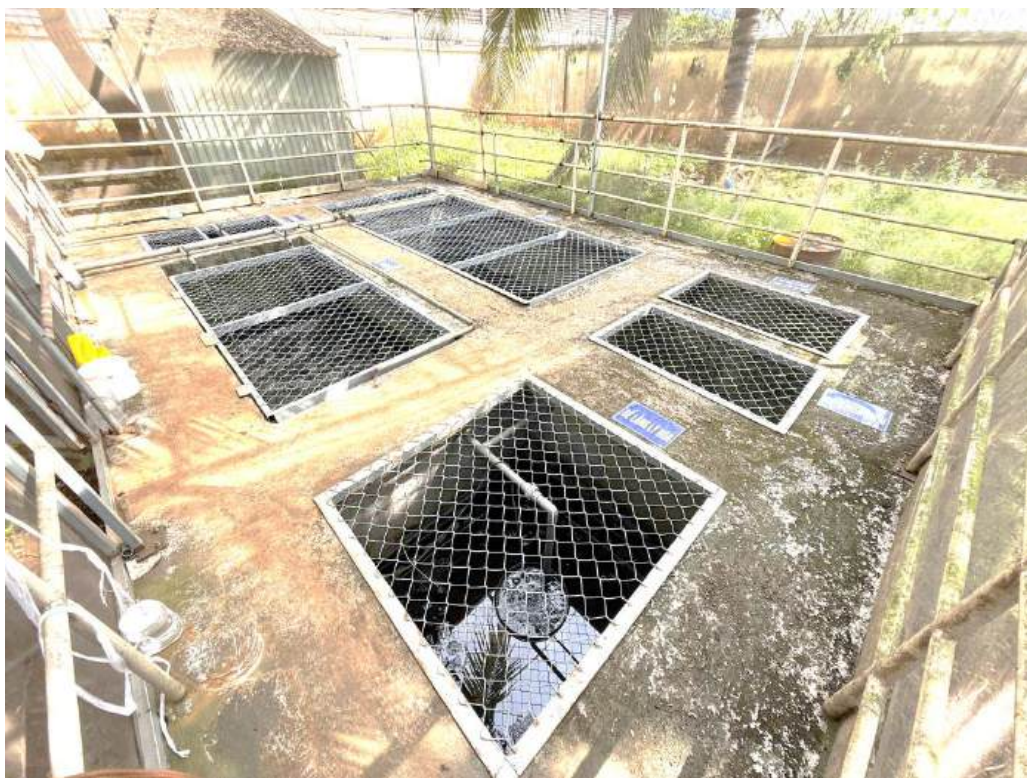
Hình 3.5 Hệ thống xử lý nước thải
